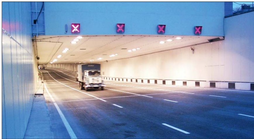
Освещение во въездной зоне
